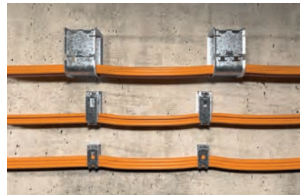
крепление кабелей к стене
