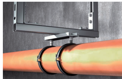
Крепление трубопровода на подвижной опоре
