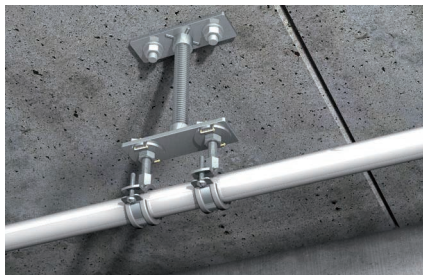
Пластиковая труба на неподвижной опоре
