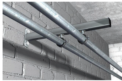
Трубопроводы, закрепленные на консолях
