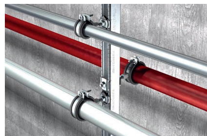
Горизонтальное крепление трубопровода
