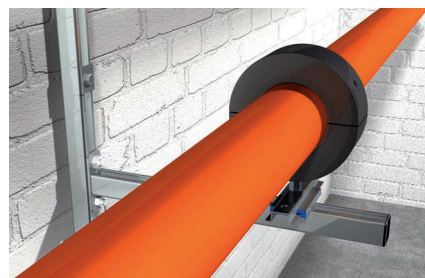
Крепление трубопровода системы холодоснабжения на скользящей опоре
