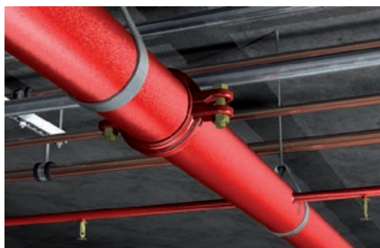
Системы аварийного пожаротушения
