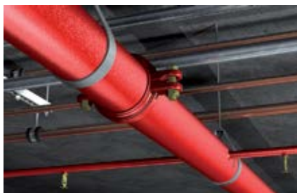
Системы аварийного пожаротушения
